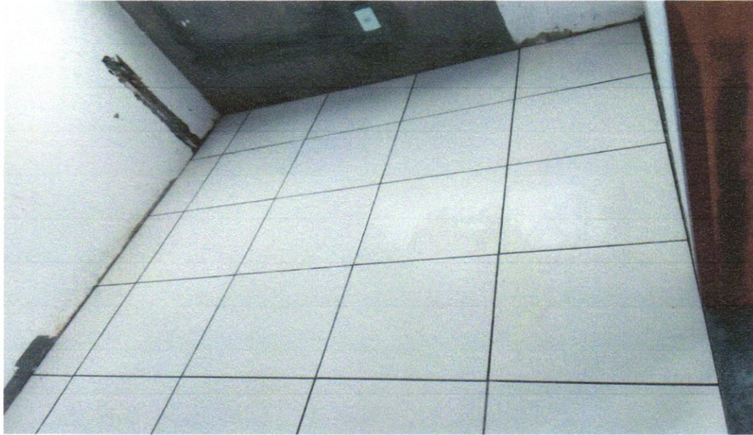
FOTO 29 - REVESTIMENTO CERÂMICO PARA PISO COM PLACAS TIPO ESMALTADA EXTRA DE DIMENSÕES 45X45 CM APLICADA EM AMBIENTES DE ÁREA ENTRE 5 M2 E 10 M2. AF_06/2014
