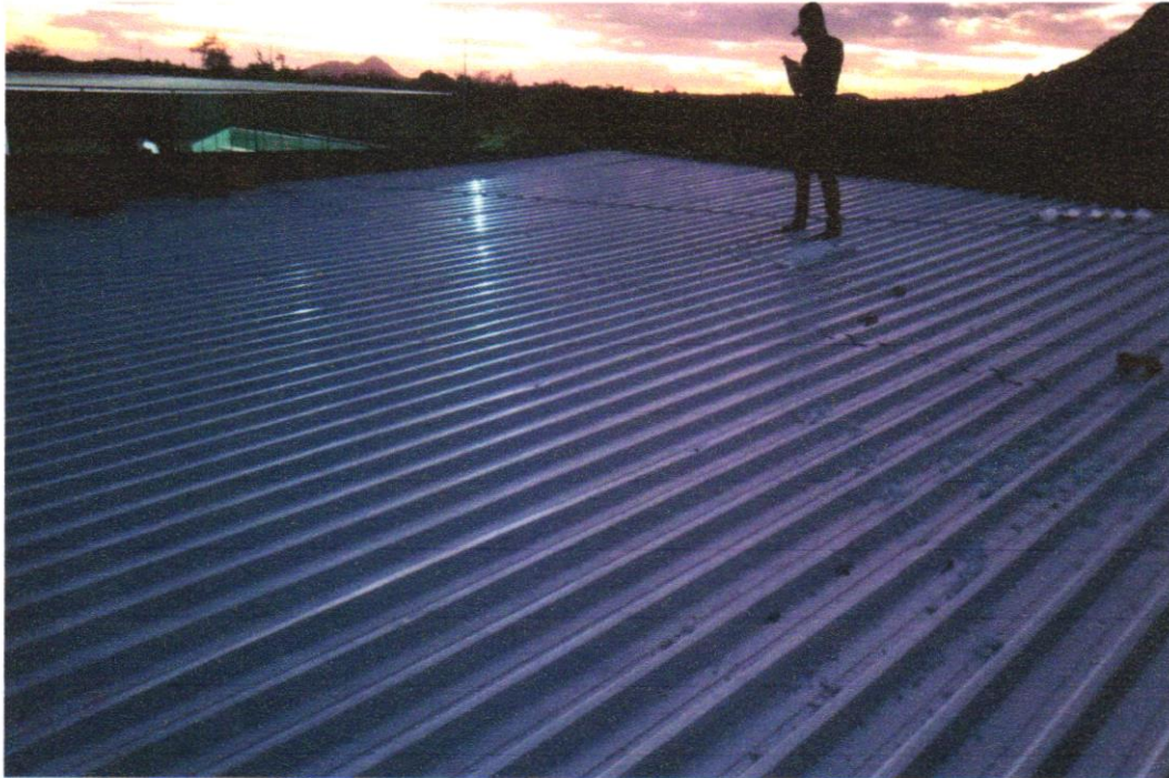
FOTO 05 – TELHAMENTO COM TELHA METÁLICA TERMOACÚSTICA E = 30 MM, COM ATÉ 2 ÁGUAS, INCLUSO IÇAMENTO. AF_07/2019
