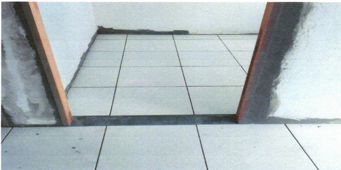
FOTO 28 - REVESTIMENTO CERÂMICO PARA PISO COM PLACAS TIPO ESMALTADA EXTRA DE DIMENSÕES 45X45 CM APLICADA EM AMBIENTES DE ÁREA ENTRE 5 M2 E 10 M2. AF_06/2014
