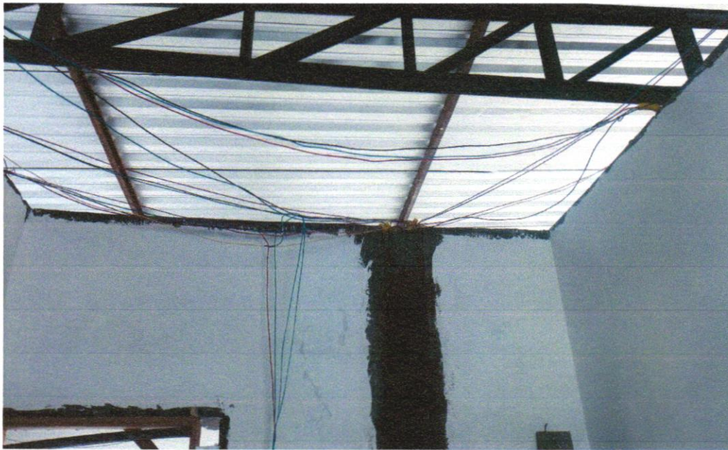
Foto 13 - CABO DE COBRE FLEXÍVEL ISOLADO, 1,5MM 2 , ANTICHAMA 6/1,0KV, PARA CIRCUITOS TERMINAIS - FORNECIMENTO E INSTALAÇÃO. AF_12/2015
