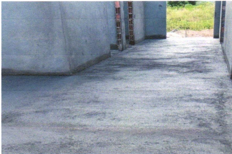
FOTO 20 - (COMPOSIÇÃO REPRESENTATIVA) DO SERVIÇO DE CONTRAPISO EM ARGAMASSA TRAÇO 1:4 (CIM E AREIA), EM BETONEIRA 400 L, ESPESSURA 3.CM ÁREAS SECAS E 3 CM 2014
